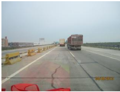
图 2.3-4（2）中央分隔带铺砌破坏
