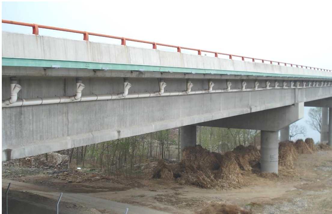
图 7.5-2 径流收集系统实景照片
